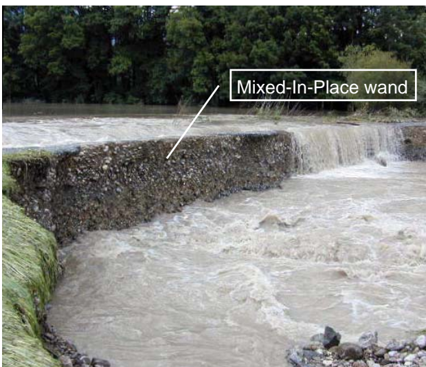
Bij overstroming van de dijk hield de MIP-wand stand
